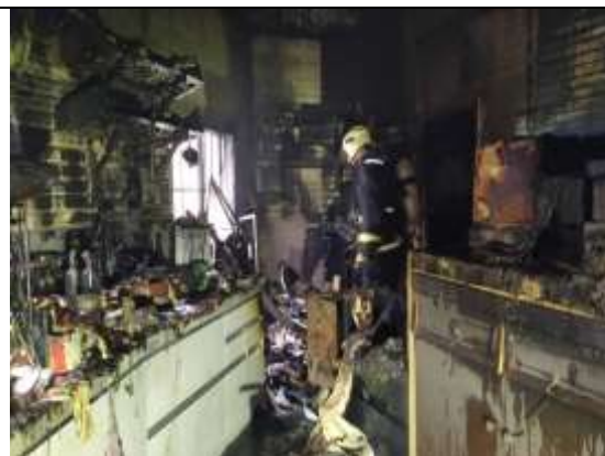
一樓廚房損毀照
