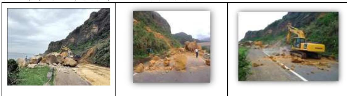
圖 52 野柳隧道口至核二廠進水口間土石崩落
