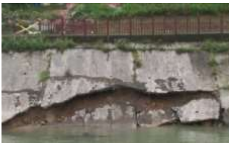
瑪鍊溪堤防崩潰
