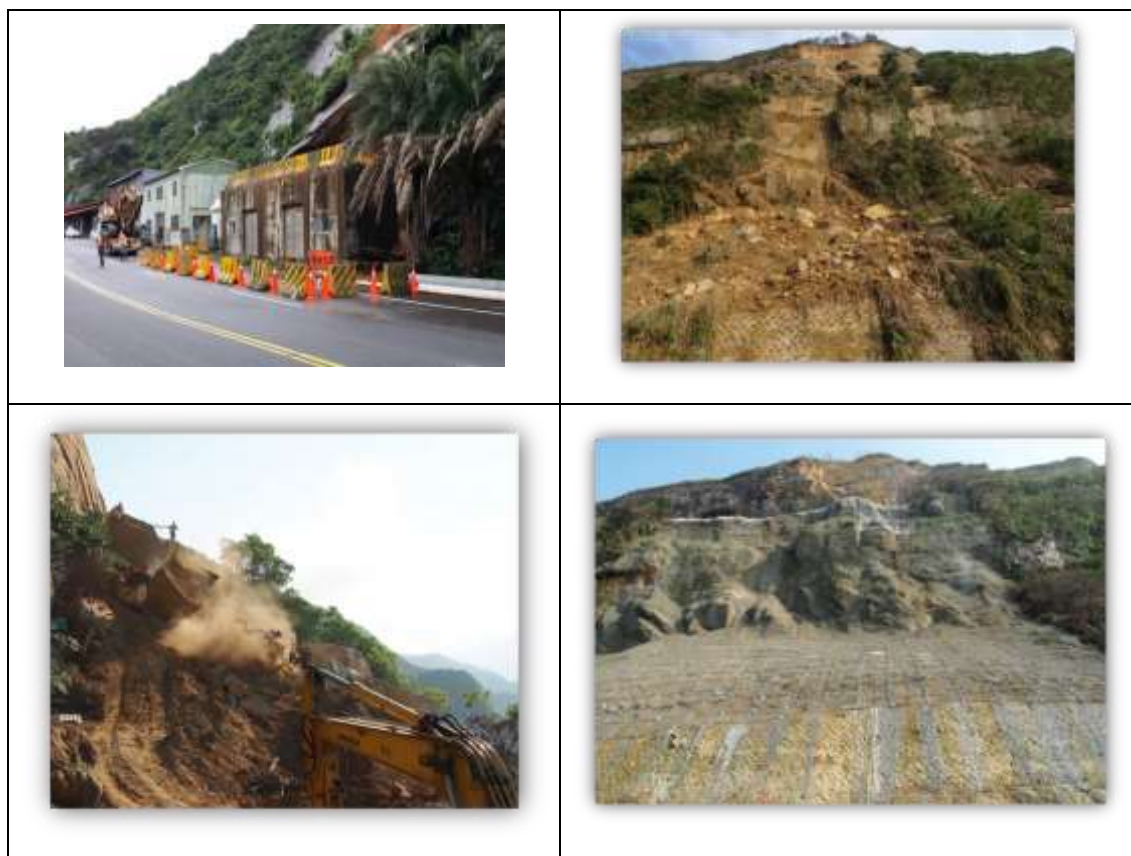
圖 54 0830 坡地災害上邊坡實況 2
